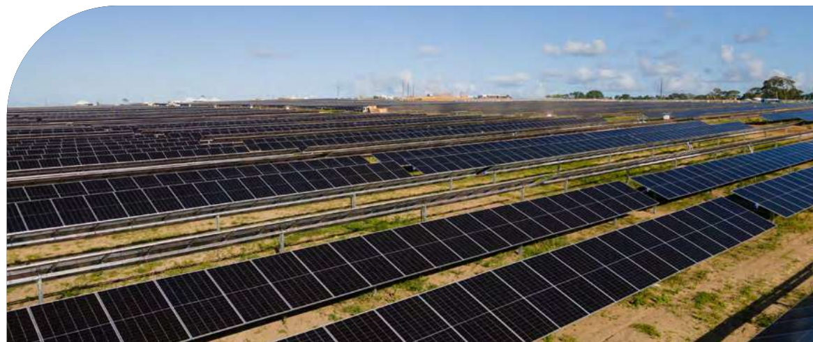
Complexo Fotovoltaico Maravilhas (PE) – Atiaia Renováveis
